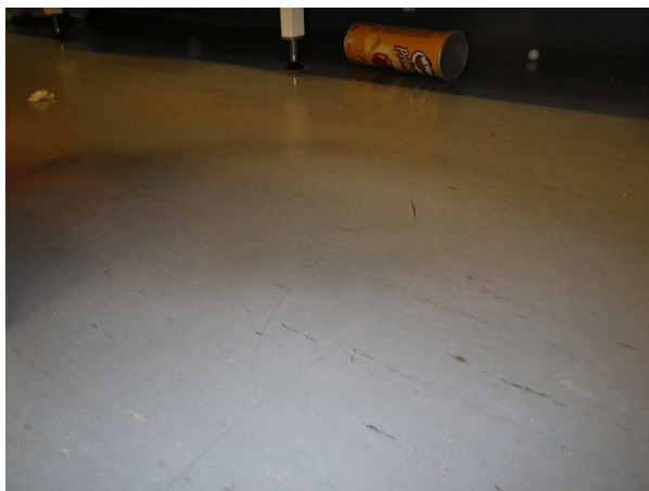
Kuva 9. Muovimatto kuprulla varaston 030 lattiassa ja maton alla on korkea kosteus.
