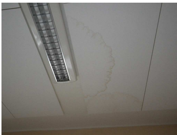
Kuva 15. Ryhmähuoneen 209 katon akustolevyissä on kosteusjälkiä ja kattopinta on ulkoseinän vierustalta muutenkin paikoin edelleen kostea.
