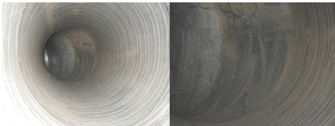
Kuva 22. Kuva tuloilmakanavasta (runkokanavasta ilmanvaihtokoneen jälkeen). Kanava on jonkin verran likainen. Oikealla lähikuvaa käyrän kohdalta.
