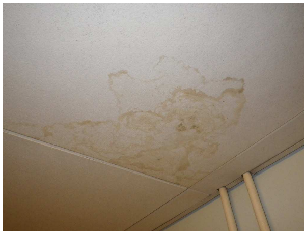
Kuva 28. Märkäeteisen 015 alaslasketun katon akustolevyissä on kuivuneita kosteusjälkiä
