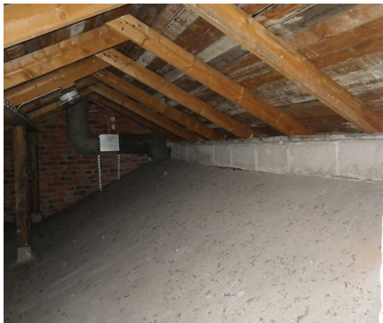
Kuva 18. Kuva ullakkotilasta vinon katon osalta (ryhmähuoneen 225 yläpuolelta, jossa on myös vino sisäkatto). Tällä osalla oli vastaavanlaisia havaintoja puuosissa kuivuneista kosteusjäljistä kuin muuallakin ullakkotiloissa
