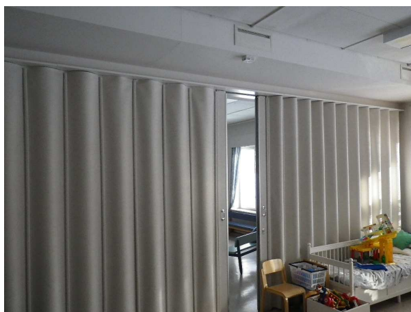
Kuva 34. Tilojen 106 ja 107 välisestä paljeovesta tulee hajua sisäilmaan.
