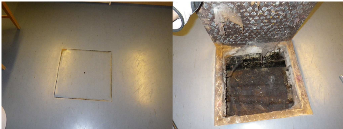
Kuva 10. Lattiassa oleva luukku kanaaliin on epätiivis. Kuva on varastosta 030. Oikeassa kuvassa on luukku avattuna.
