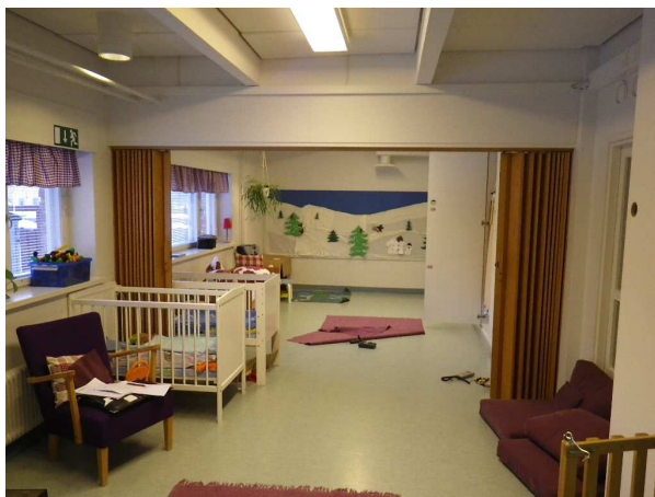
Kuva 6. Päiväsaiteiden-ryhmän ryhmähuone 001, jossa lattioissa havaittiin kosteutta suurella osalla aluetta.
