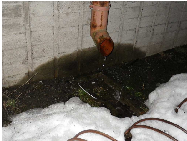
Kuva 1. Rakennuksen pohjoissivulla katolta tulevat sadevedet laskevat loiskekupille, josta ne osittain roiskuvat ulkoseinälle kastellen seinän alaosa.
