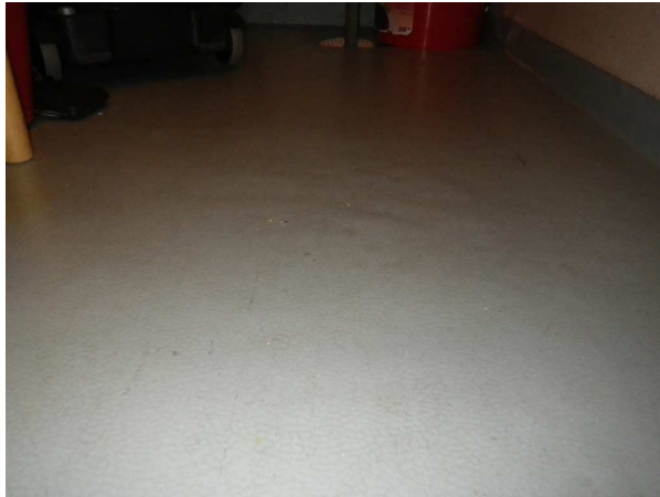
Kuva 24. Pesuhuoneen 002 matto on osin pohjasta irti (kosteuden aiheuttamaa kupruilua)
