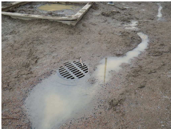
Kuva 3. Länsipäädystä pihan hiekat valuvat veden mukana sadevesikaivoihin.
