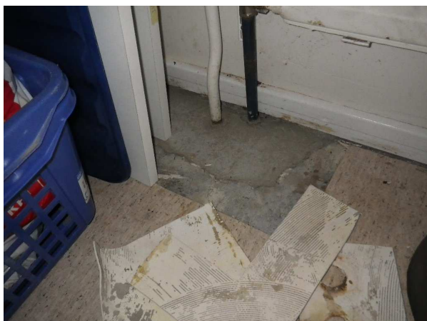
Kuva 38. varaston 205 patteriputki on joskus vuotanut. Samassa kohdassa alapuolella varaston katossa oli kuivuneet kosteusjäljet
