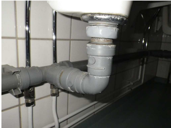
Kuva 42. Pesuhuoneen/ wc:n 227 pesualtaan viemäriiitos tiputtaa vettä vähän lattialle.
