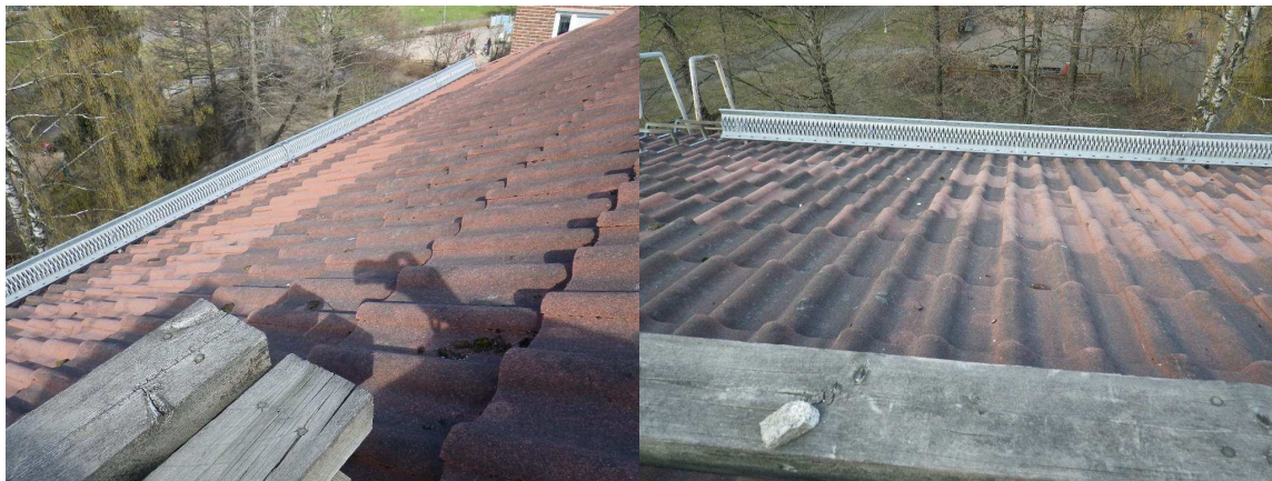
Kuva 21. Yleiskuvaa vesikatolta. Räystään läheisyydessä on uusittua vesikatetta, joka on ilmeisesti vaihdettu aiemmin mainittujen vesikattovuotojen yhteydessä.
