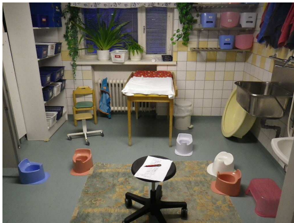
Kuva 8. Päivänsäteiden pesuhuoneen 002 lattiassa on myös kohonneet kosteudet muovimaton alla
