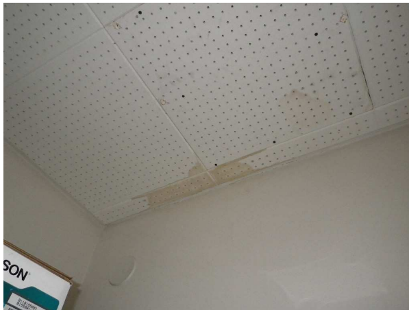
Kuva 32. Varaston 102 katon akustolevyissä on vanhoja vuotojälkiä yläpuolella olevan patterin vuotamisesta johtuen.
