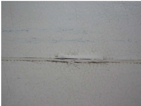
Kuva 36. Pesuhuoneiden muovimattojen saumat ovat paikoin auki. Kuva pesuhuoneesta 112.
