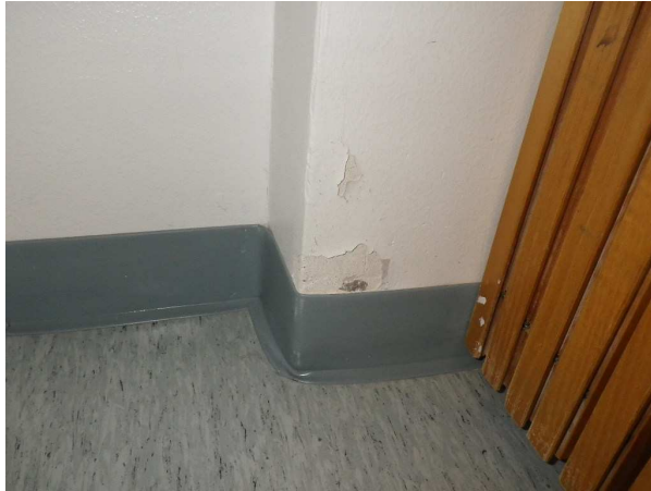
Kuva 7. Alhaalta päin nousevaa kosteutta pilarin alaosassa ryhmähuoneessa 001.
