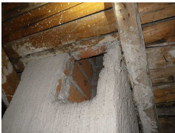
Kuva 19. Kuva ullakolla olevasta vanhasta hormista, josta on todennäköisesti ilmayhteys sisätiloihin.
