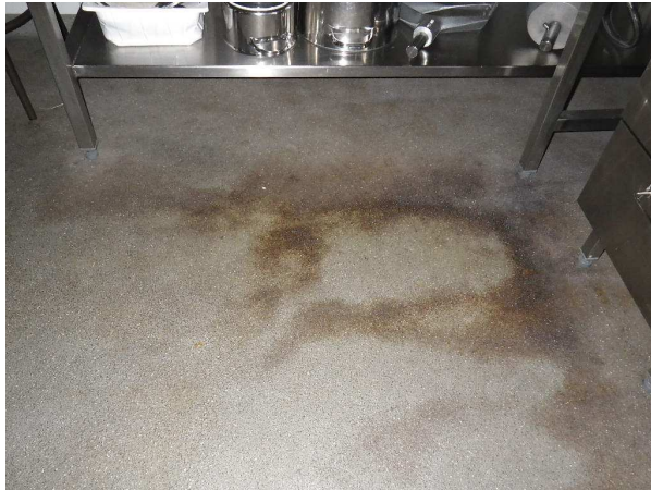
Kuva 29. Keittiön lattiassa on tummia laikkuja. Kyseisillä alueilla ei mitattu muusta lattiapinnasta poikkeavia kosteuslukemia.
