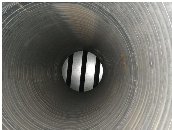
Kuva 23. Tuloilmakanavan ääneneristys on tehty lamellien avulla.
