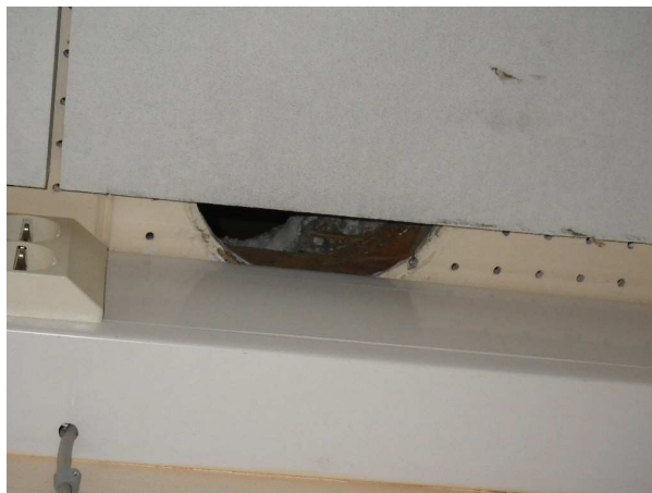
Kuva 41. Tietokonetilan katossa on reikä, joka on ilmeisesti yhteydessä vanhaan ilmanvaihtohormiin.
