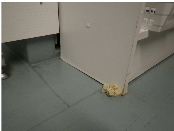
Kuva 26. Pesuhuoneen 002 suihkunurkan edessä oleva lastulevyrunkoisen kaapin alaosat ovat kastuneet / turvonneet
