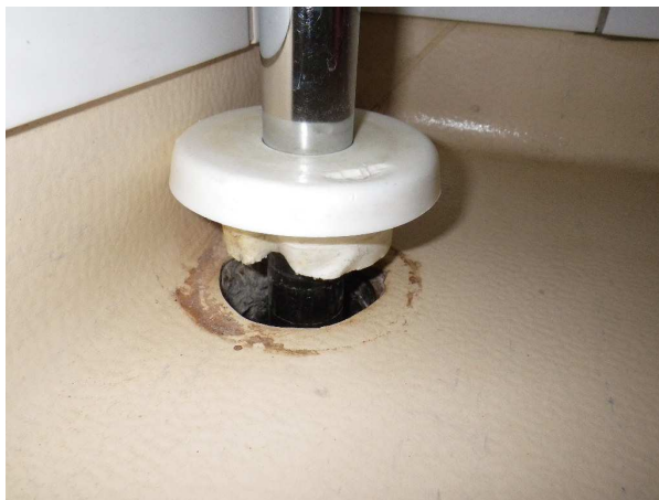
Kuva 33. pesuhuoneen 103 pesualtaan tiivistys voi olla puutteellinen (viemärihajujen mahdollisuus). Kuvassa tiivistettä on nostettu tarkoituksellisesti ylöspäin.
