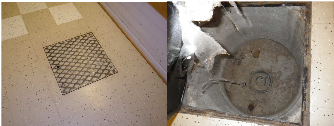
Kuva 12. Vasemmassa kuvassa pohjaviemärin tarkastuskaivon päällä oleva teräsluukku, joita on käytävillä 008 ja 027. Kuva on käytävältä 027. Oikeassa kuvassa luukku avattuna, pohjalla näkyy pohjaviemärin tarkastus-/ puhdistusluukku.
