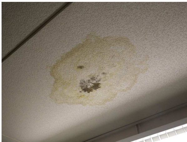
Kuva 30. Katossa on pieni kostea alue, joka johtuneen yläpuolella olevan putken hyvin pienestä vuodosta
