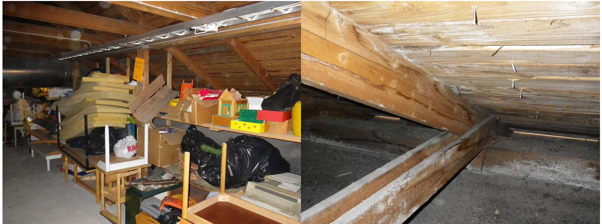
Kuva 17. Vasemmalla yleiskuva ullakolta, oikealla yläpohjan puurakenteita, joissa on kauttaaltaan kuivuneita kosteusjälkiä
