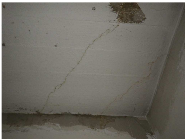
Kuva 16. Alaslasketun katon akustolevyjä siirrettiin sivuun (kuva pesuhuoneesta 213). Vanhassa kattopinnassa on hiushalkeamia, joiden kohdalta on valunut aiemmin vettä.
