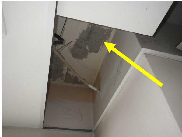
Kuva 39. Alaslasketun katon sisällä on betonipinnassa jyräjäjälkiä vanhaan vahinkoon liittyen. Kuva leikkikeittiöstä 210.
