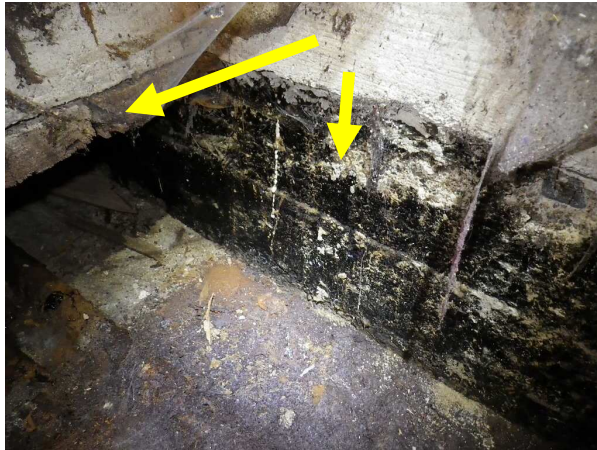
Kuva 11. Kanaalissa on muottilaudat, jotka ovat mikrobivaurioituneita. Kanaalissa on voimakas mikrobivaurioon viittaava haju. Kanaali on sisäpuolelta pikieristetty. Pikieristys ei sisältänyt merkittäviä määriä PAH-yhdisteitä.
